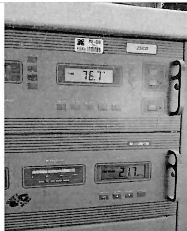
Se pone en operación el transmisor, se checa que no tenga alguna otra alarma, y se deja trabajando.
